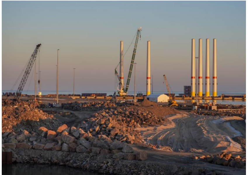
✓ Nahe der dänischen Insel Bornholm unterstützt die EU finanziell den Bau der Bornholm Energy Island . Hier soll ab den 2030er-Jahren der Strom mehrerer Windparks in der Ostsee zusammenfließen und je nach Bedarf anteilig in die dänischen und deutschen Stromnetze eingespeist werden.
