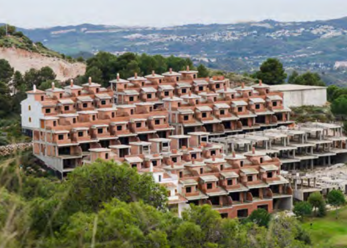
Unvollendeter Appartementblock an der Costa del Sol, Andalusien, 2018
